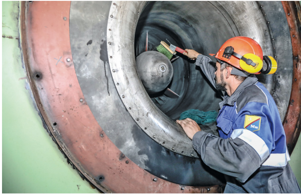
Подготовка к зиме – это широкий перечень работ: от обслуживания агрегатов до ремонтов на линейной части (фото: Оксана Платоненко)
