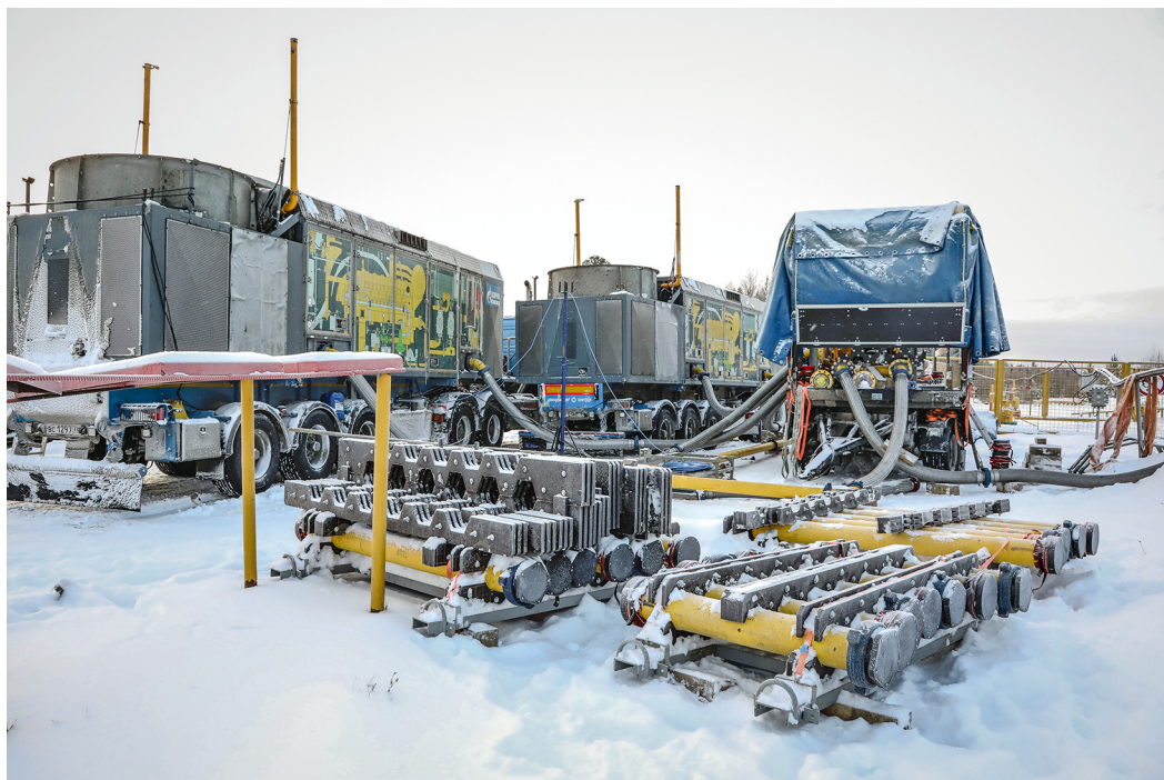
МКУ – это маленькая компрессорная станция, у которой есть практически все, что положено иметь «казаске», входные и выходные шлейфы, а также два компрессора в роли ГПА (фото: Оксана Платоненко)
