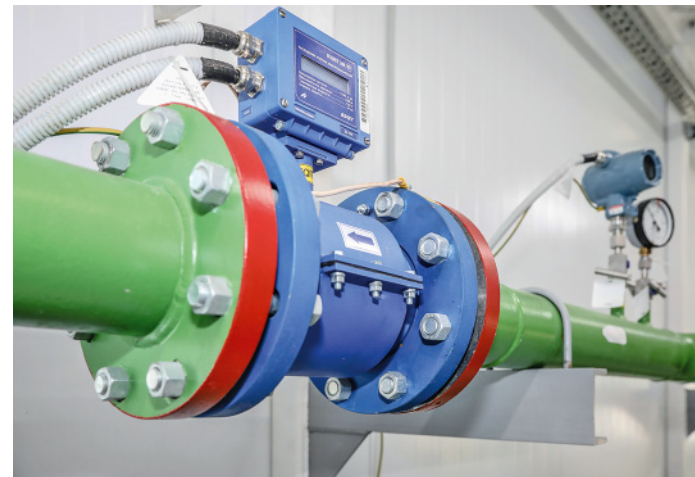
Узел учета воды «Взлет» позволяет точно узнать, сколько ее уходит на хозяйственные нужды поселка и компрессорной станции
