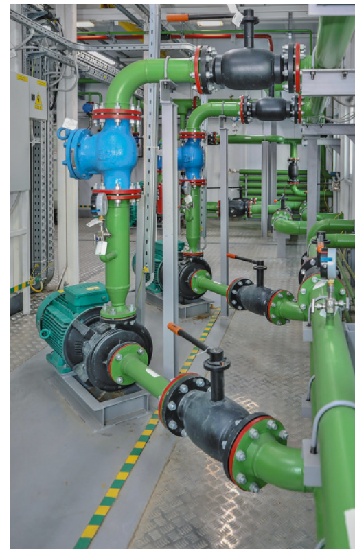
На станции установлены три насоса для хозяйственно-производственного водоснабжения и два – для противопожарного. Изготовлены они на российском заводе ООО «ВИЛО РУС» в Москве
