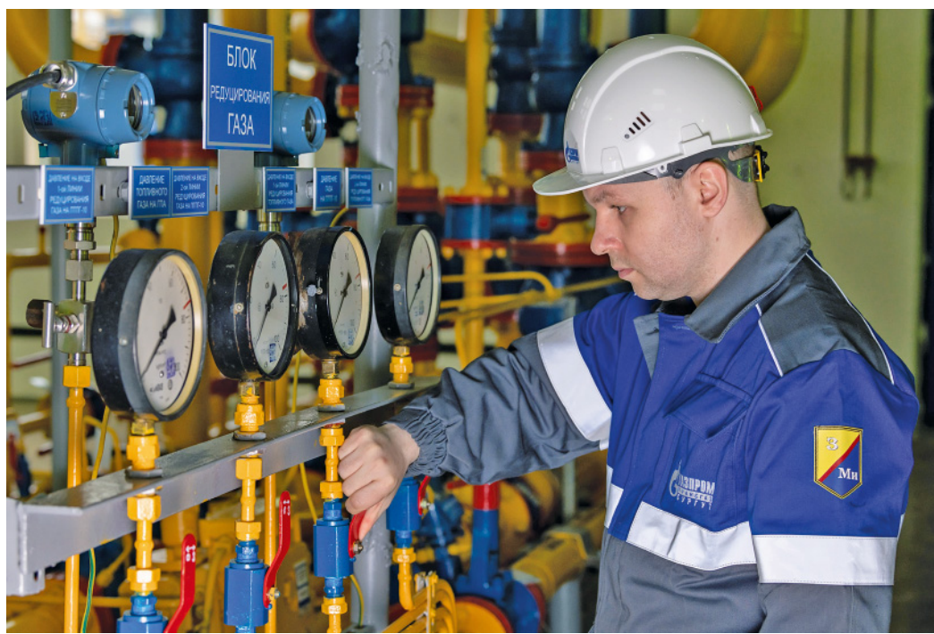
В обязанности специалистов САиМО входит постоянный контроль за работой контрольно-измерительных приборов и автоматики. На снимке – инженер по АСУП Евгений Токарев (фото: Алексей Царьков)
