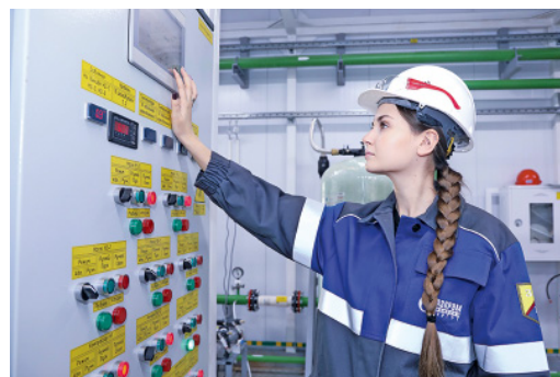
Оператор насосной станции Анна Лен уже освоила работу с новым оборудованием
