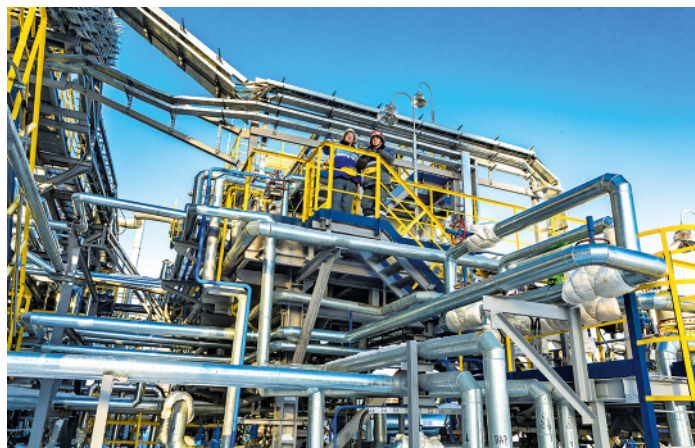
Установка очистки пропановой фракции – один из новых объектов. Здесь сжиженный газ очищается от метанола
