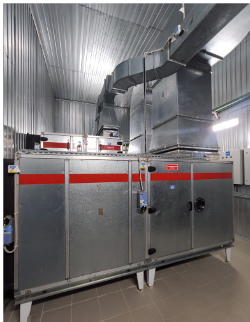
А это уже новая система – центробежный вентилятор на той же КС-2
