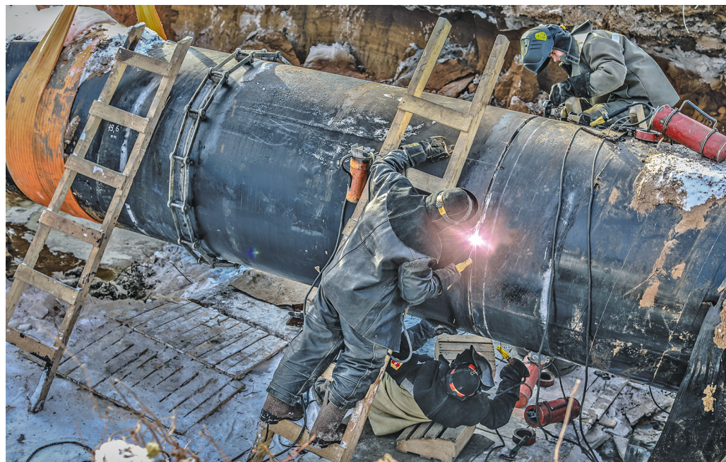
Азот используется для продувки и осушки участков газопроводов после проведения ремонтных и огневых работ
