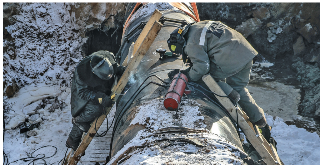
Опыт последних ремонтных кампаний показал, что ЛПУ многое могут делать своими силами. На фото – работы в Пурлейском линейном производственном управлении
