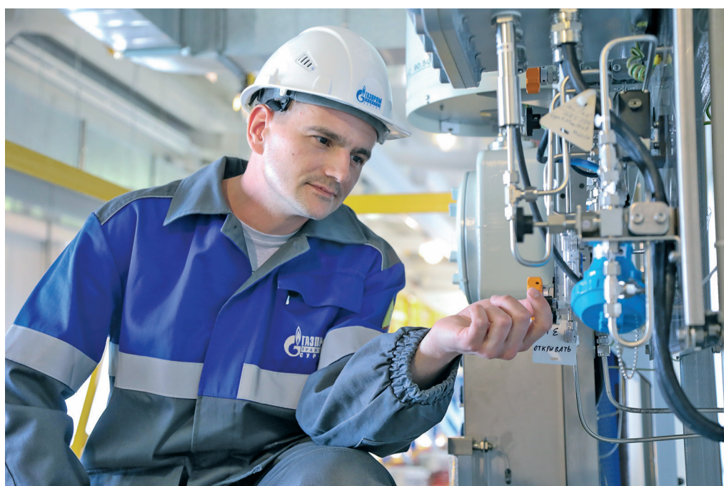
Инженер САИМО Игорь Полшков проводит обслуживание анализатора кислорода на ГИС Богандинской промплощадки
