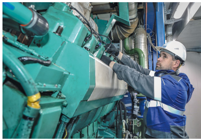
Одна электростанция собственных нужд Cummins на 11,36 МВт покрывает все нужды Управления. Вторая находится в резерве
