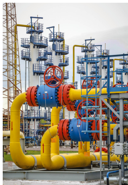
Технологическая обвязка фильтров-коагуляторов, очищающих газ от механических примесей и масла перед подачей на сборные пункты и далее в скважины
