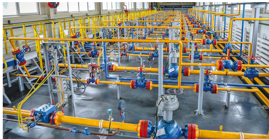
На шести сборных пунктах Невского ПХГ газ отделяют от воды, очищают и проводят полную его подготовку для транспортировки
