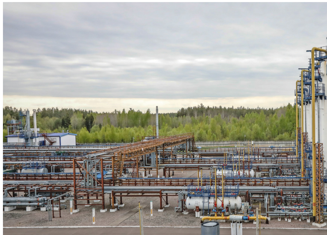
Установка осушки газа. Ее функция – окончательная очистка и осушка газа перед подачей в магистральные газопроводы
