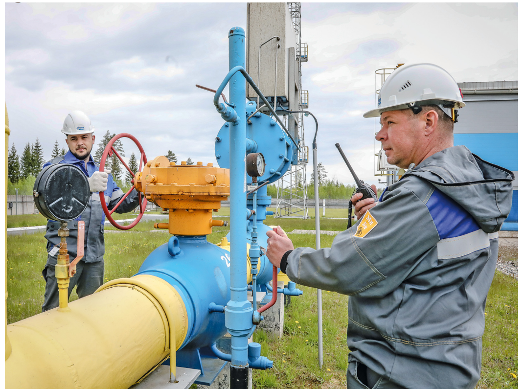
Оператор Кирилл Осипов и бригадир Вячеслав Борисов отвечают за работоспособность оборудования СП-6
