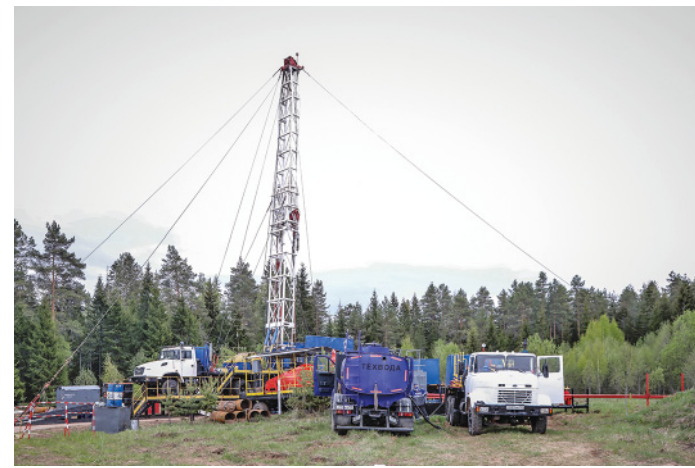
Специалисты четырех УАВР и КРС ООО «Газпром ПХГ» обслуживают и ремонтируют весь фонд скважин компании
