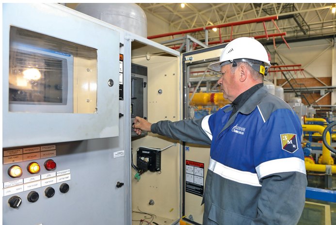
Импортная автоматика компрессорных цехов постепенно заменяется на отечественные образцы оборудования
