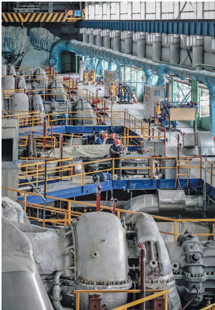
Импортные комплектующие на компрессорных станциях Общества постепенно заменяются на отечественные аналоги
