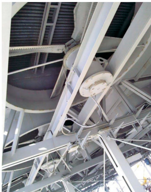
Двигатель ВАСО, установленный на аппаратах воздушного охлаждения газа
