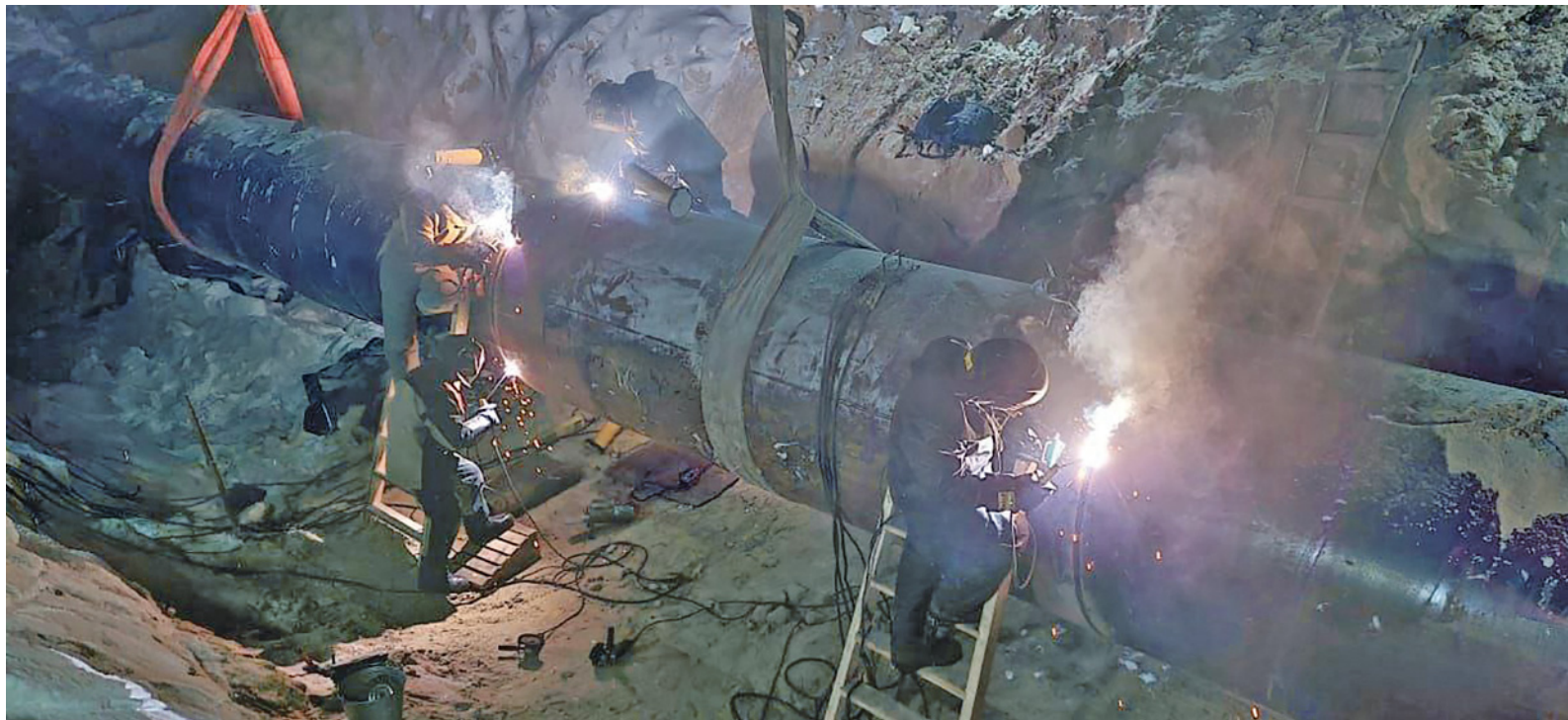
Сварщики РЭП Ново-Уренгойского ЛПУ впервые проводят капитальный ремонт МГ своими силами (фото: Ново-Уренгойское ЛПУ)
