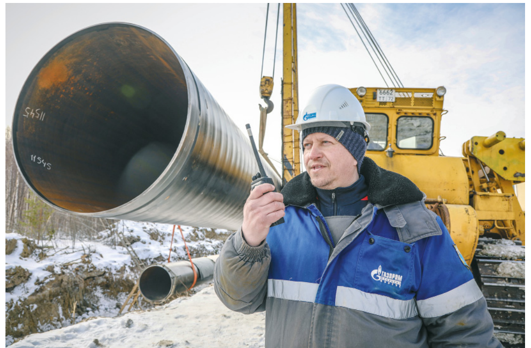
Максим Данилов, главный инженер Демьянского ЛПУ
