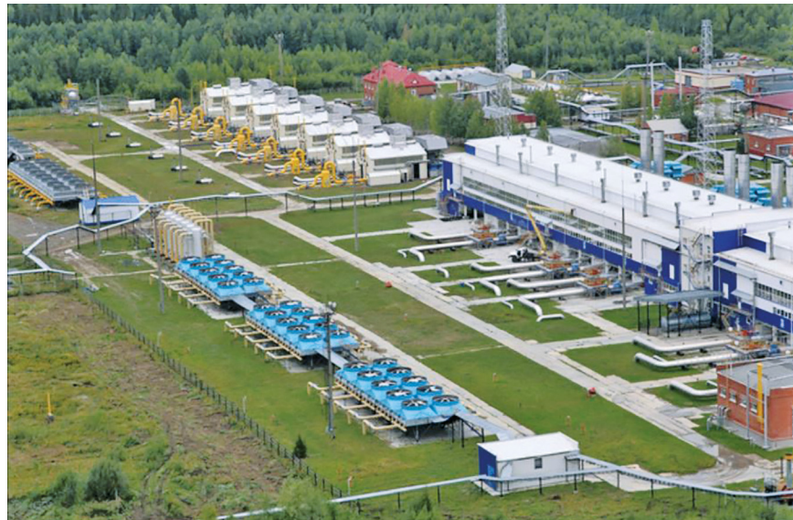
Туртасская компрессорная станция с высоты птичьего полета
