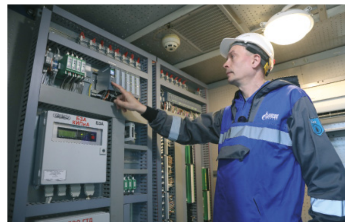
«Мозги» агрегата: в блоке управления системой МСКУ-6000
