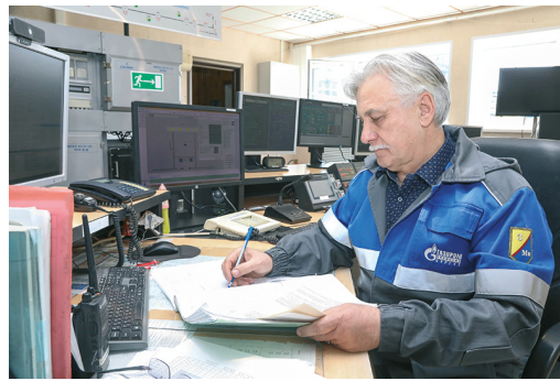
На главном щите. Контроль за транспортом газа ведется круглосуточно
