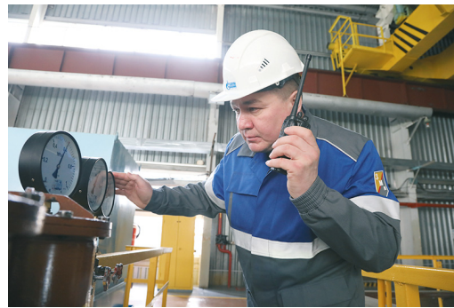
Исправность оборудования – это понятие ежедневного контроля
