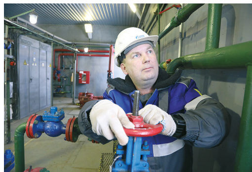
Вентили в тепловых котельных, так же как и газовые, должны быть в надежных руках
