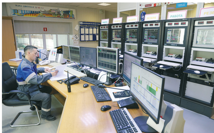
Главный щит КС-7, как и на любой станции, – главный орган управления
