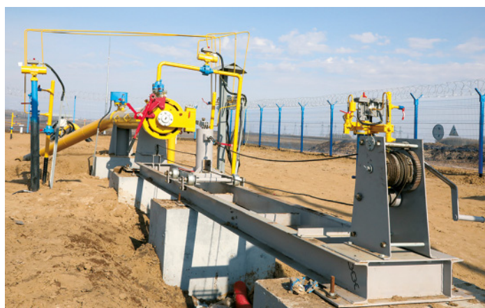
Газопровод-отвод изначально оснащен камерами приема-запуска
