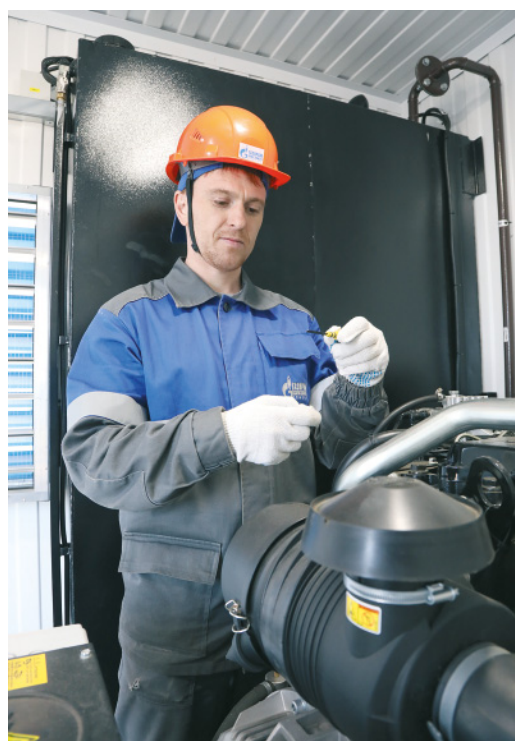
Электромонтер Владимир Лифшиц производит проверку масла на аварийном генераторе
