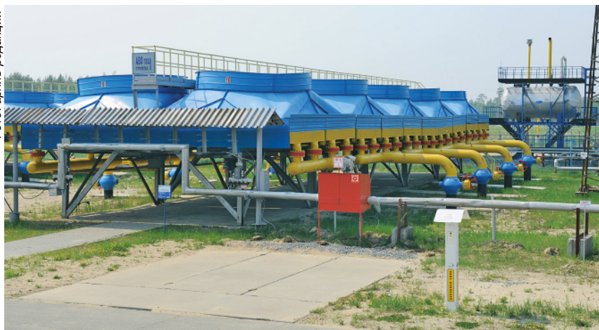
Группа АВО газа французского производства на КС-3 станет первым опытом комплексного импортозамещения оборудования на компрессорных станциях Общества
