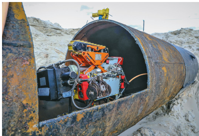
Штатный комплекс ТДК-400-М-Л с кабельным интерфейсом, примененный при ВТД первого цеха КС-03
