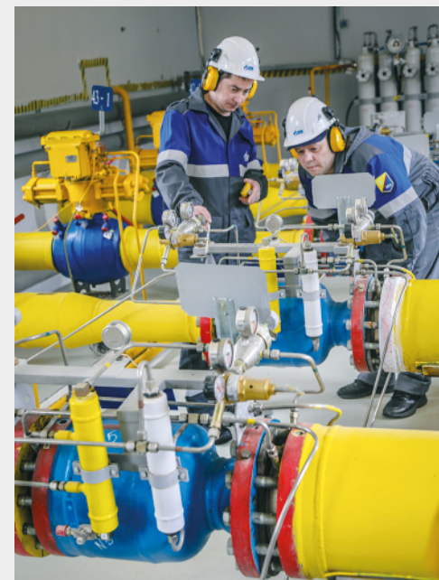
Редуцирование газа на ГРС – важный процесс на пути «голубого топлива» к потребителю. На фото – газораспределительная станция ТЭЦ-1 Богандинского ЛПУ
