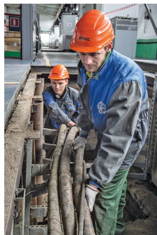
2017 год. Идет замена кабельных линий электроприводного цеха на КС-9. Питание агрегатов должно быть надежным и бесперебойным
