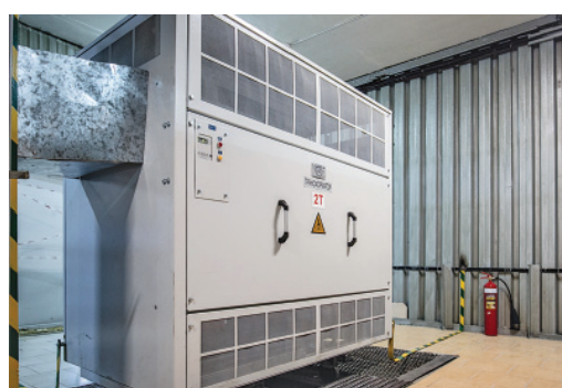
Электрооборудование объектов Общества постепенно заменяется на более современное и энергоэффективное. На фото – новый трансформатор
