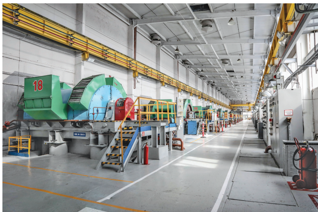
Один из двух компрессорных цехов КС-5. Здесь, как и на других электроприводных станциях нашей трассы, исправно трудятся «старички» СТД-12500
