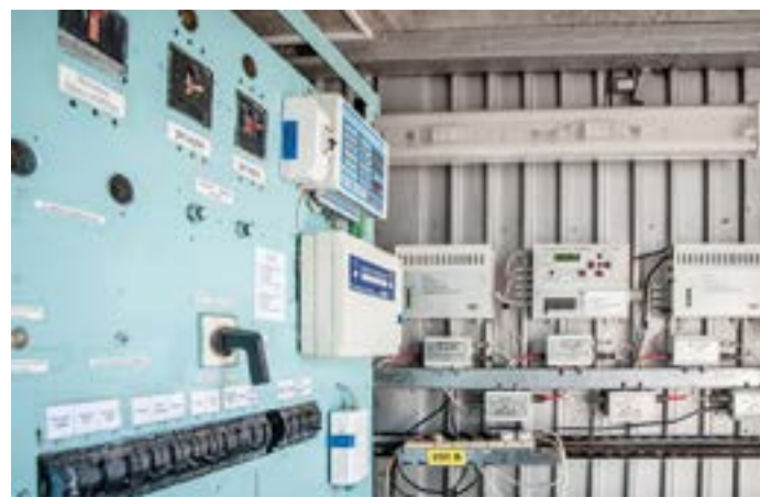
В блоке управления «Ташкента». Старые, еще советские тумблеры гармонично соседствуют с современным цифровым оборудованием
