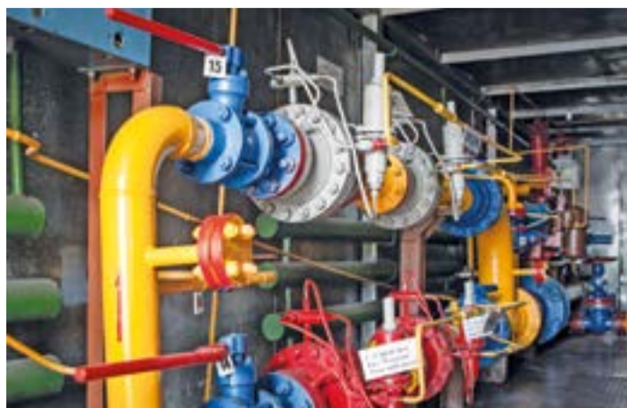
Внутри технологического блока. Здесь газ редуцируется, понижаясь до безопасного давления
