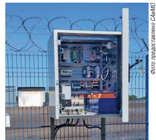
На крановых узлах Тобольского, Богандинского и Ишимского ЛПУ уже установлена новая система телемеханики
