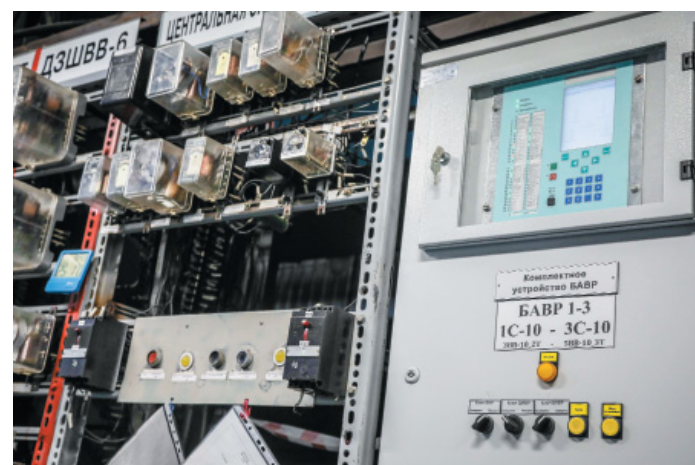
Так выглядит оборудование системы БАВР – быстродействующего автоматического ввода резерва. Его задача – не допускать остановки агрегатов
