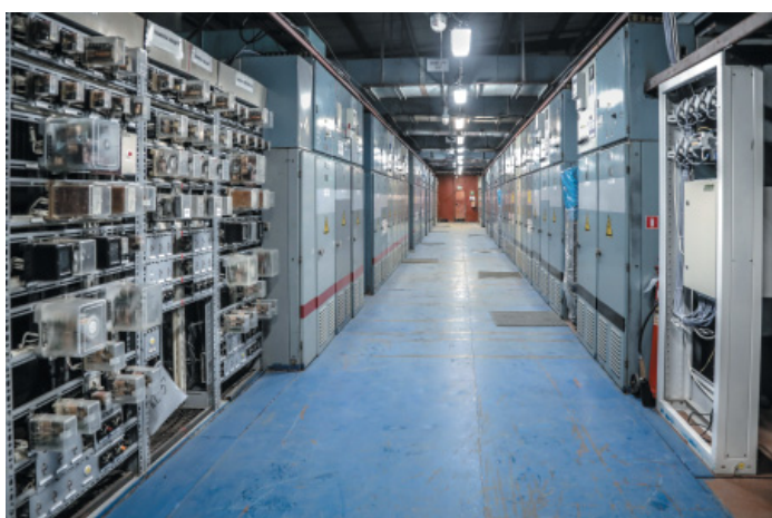
ЗРУ – закрытое распределительное устройство. Именно такие установки обеспечивают питанием наши электроприводные цеха. Снимок сделан на КС-5
