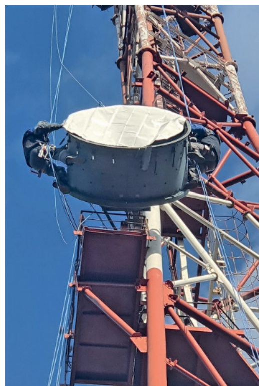
Монтаж с применением канатного доступа. Раньше такие работы своими силами не выполнялись
