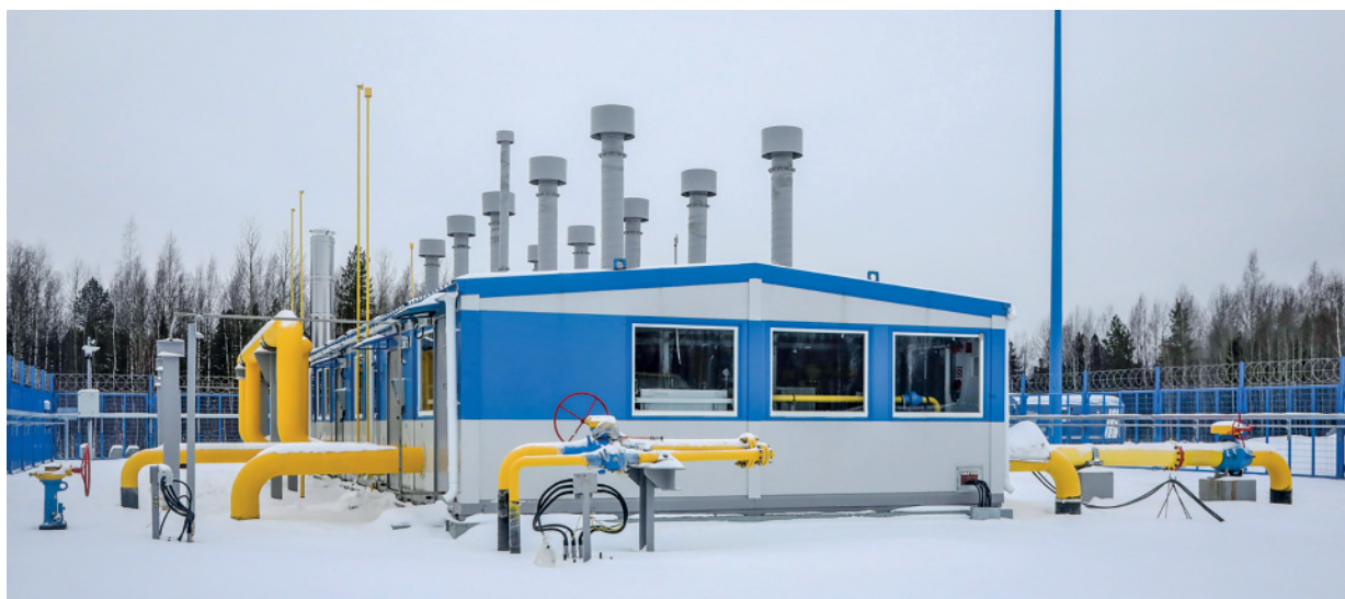
ГРС «Каркатеевы» – новейшая станция блочной конструкции
