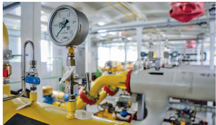
Оборудование ГРС готово к подаче газа
