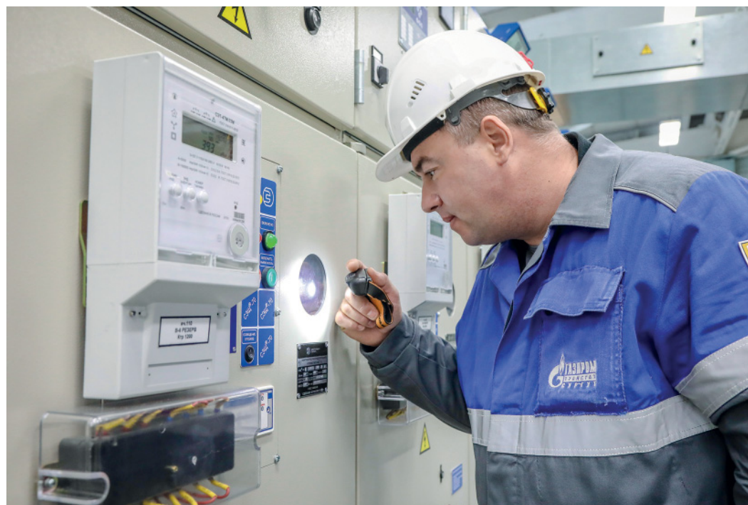
Электромонтер службы ЭВС КС-1 Александр Петрасюк признан одним из лучших уполномоченных по охране труда в Обществе по итогам 2023 года
