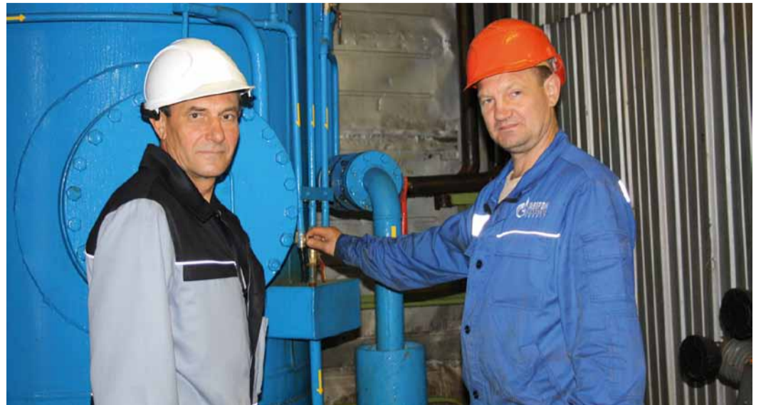
Мастер КС-02 Сергей Жупанов и оператор химводоочистки Алексей Кролик в помещении насосной второго подъема
