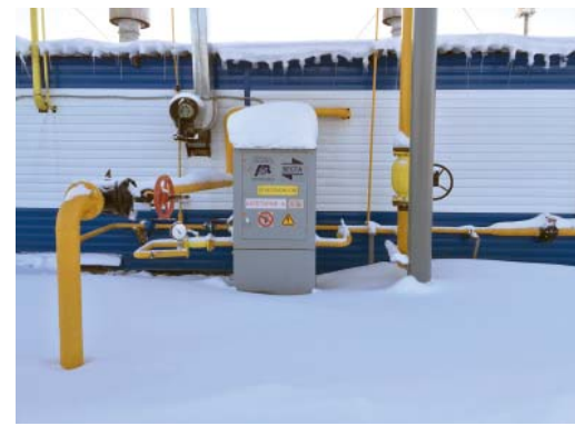
Новый одоризатор – один из объектов газопровода среднего и низкого давления
