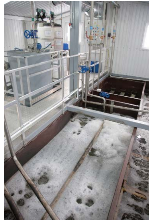
Фильтрующие установки КС-5 делают процесс очистки воды передовым на предприятии
