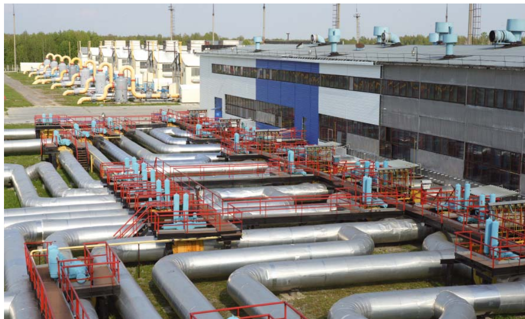
Одна из приоритетных задач на будущее по промплощадкам — это проведение комплексной диагностики технологической трубопроводной обвязки компрессорных цехов, так называемой «гитары».
