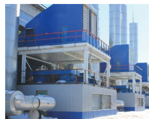
Новые укрытия АВО масла на КС-03
