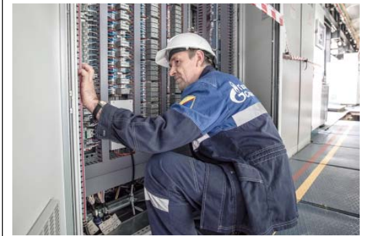
Электрооборудование цеха КС-9 полностью обновили
