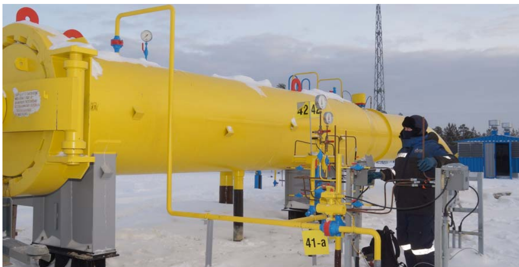
Камера приема-запуска на КС-1 (фото: Вынгапуровское ЛПУ)
