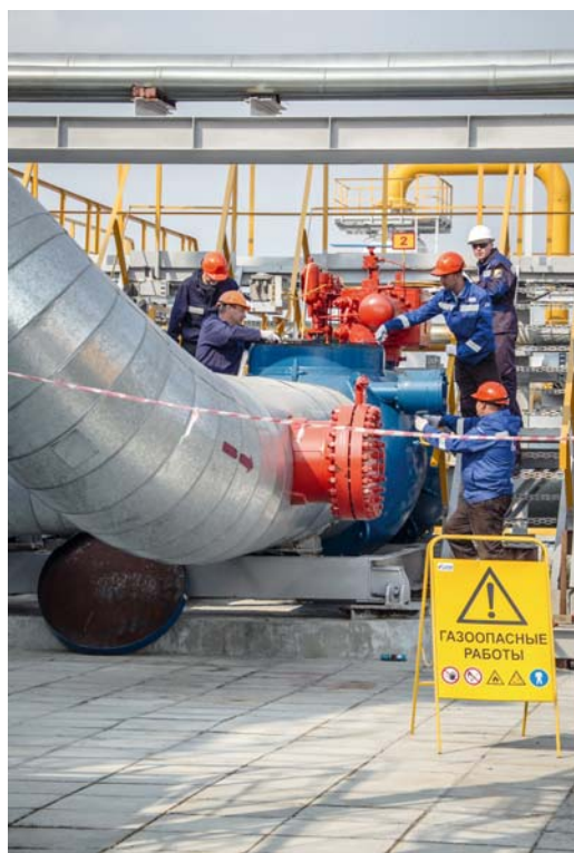
Иван Машков и его бригада выполняют работы на трубопроводе. Все строго по правилам ОТиПБ
