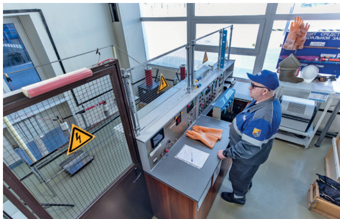
Чтобы никого не ударило током, СИЗы подвергаются испытаниям
