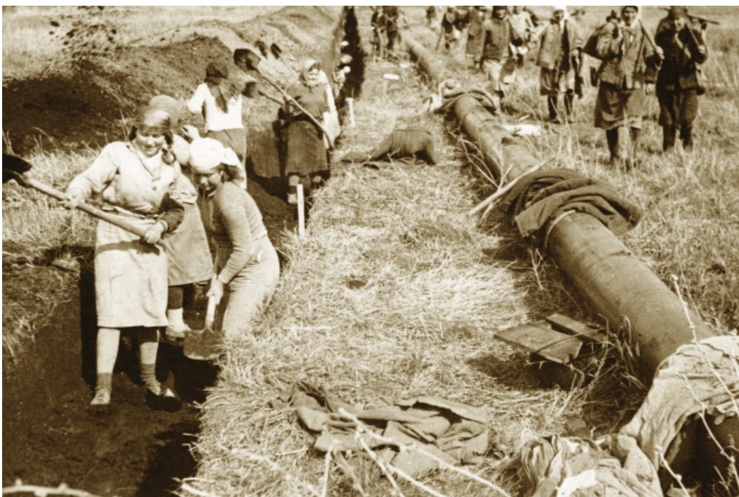
1945 год. Строительство газопровода «Саратов – Москва». Василий Сеньюков понимал, что прокладывать газовые магистрали тяжело и дорого. Поэтому впоследствии искал способы упростить эту задачу
