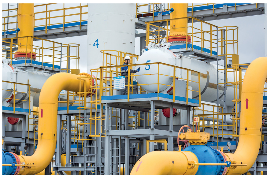
Цветовое оформление технологических трубопроводов строго регламентировано (фото: Рамиль Нуриев)
