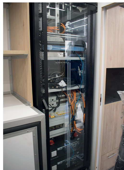
Шкаф с оборудованием связи
