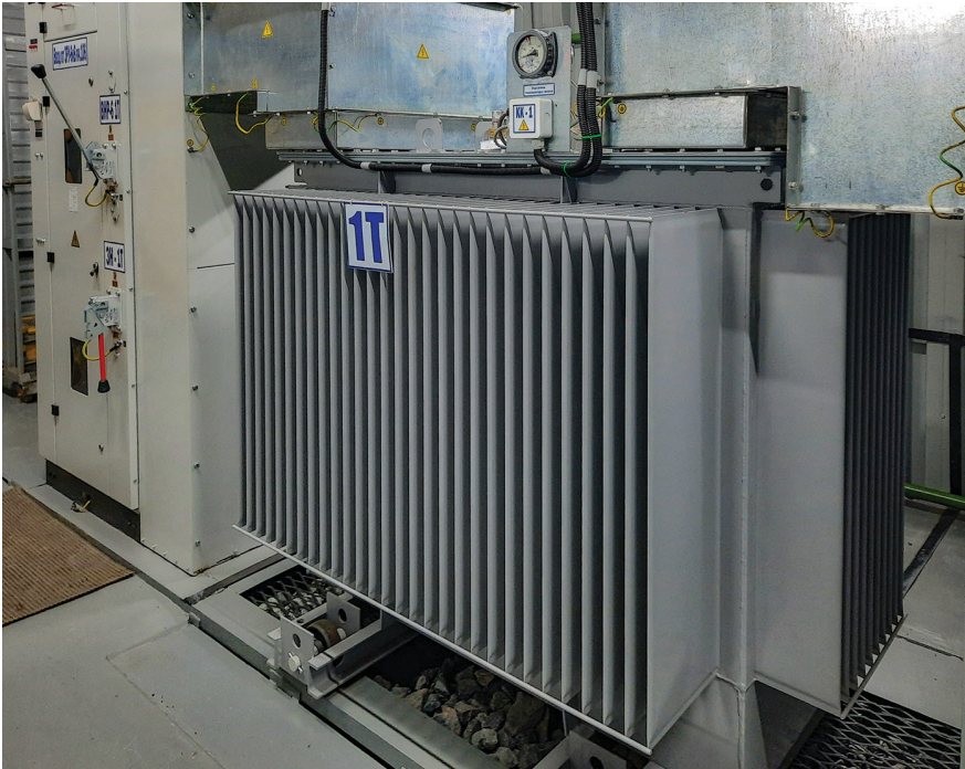
Реализация проекта позволит прогнозировать состояние силовых трансформаторов, используемых на КС «Губкинская», и, при необходимости, принимать соответствующие решения (фото: КС-03)
